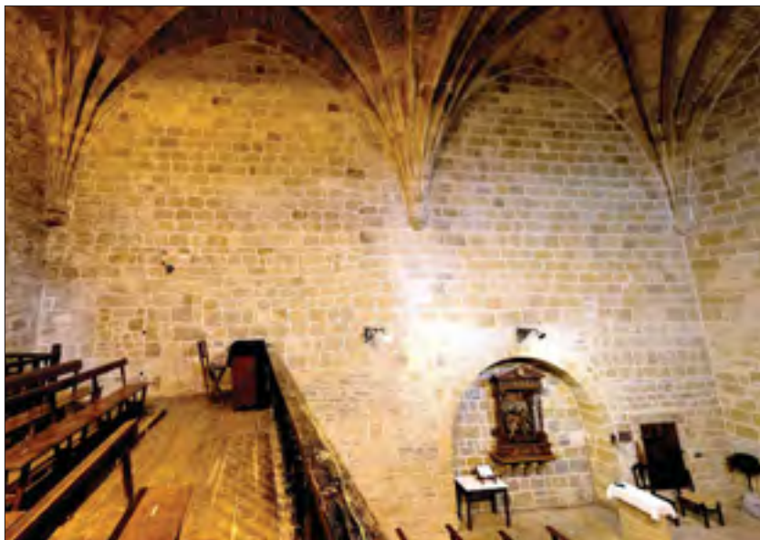
Fig. 32. San Martín de Askizu: Vista de conjunto del paramento interior del muro norte, con el despiece de los aparejos.
