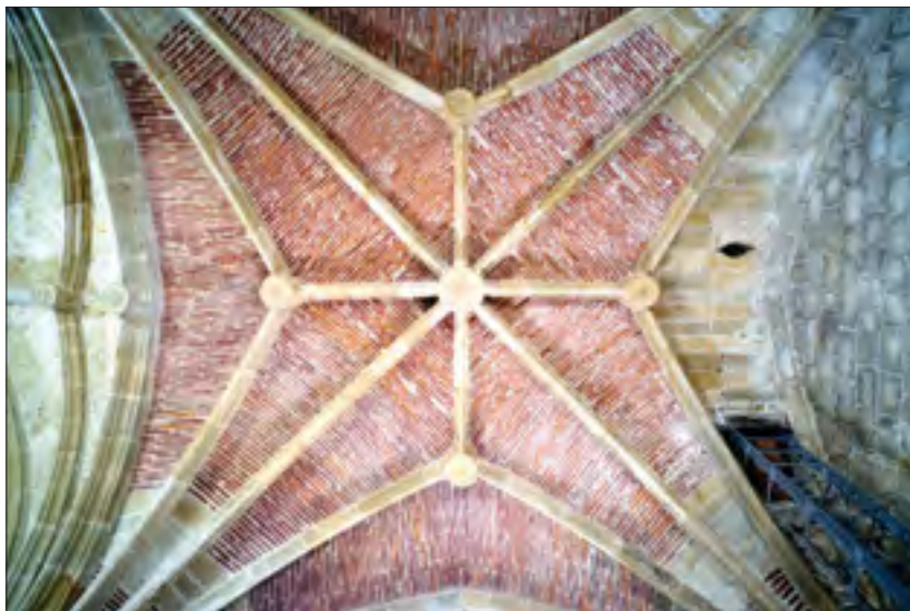
Fig. 16. San Martín de Askizu: Bóveda sobre el coro, igualmente gótica de terceletes, con nervios de piedra arenisca, pero con plementos de ladrillo macizo y losas de arenisca en el acceso a la cubierta. El detalle permite ver el huequecillo, previsto para pasar una cuerda para tañer las campanas, cuyo desgaste indica su empleo. Obsérvese, también, cómo las claves son más grandes que en la otra bóveda, algo más antigua.
