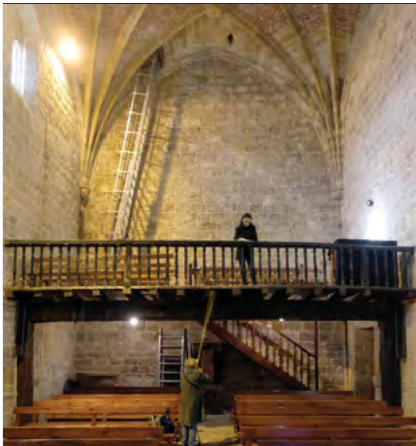
Fig. 34. San Martín de Askizu: Paramento interior del muro occidental, es el más moderno del edificio, y sin duda por ello, también el más homogéneo de todo el edificio, con el corito elevado y las inestéticas (pero necesarias) escaleras metálicas (quien se ha cimbreado en una escalera oscilante, agradece la seguridad).
