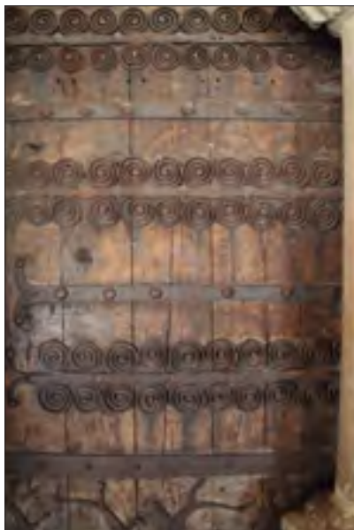
Fig. 31. Detalle de la preciosa puerta principal de madera de Andra Mari del s. XVII con aderezos y clavos de hierro. (Fotografía de F. Caballero).
