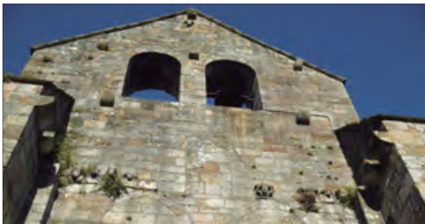
Fig. 17. Canchillos en el hastial de la torre de campanas con la parte superior plana, a la misma altura que la parte más alta de los modillones de los contrafuertes y de las pilastras adyacentes a estos. También se observan tres posibles vanos tapiados, según algunos especialistas, pero los dos más grandes, en la parte inferior, no lo son, ya que no atravesaban el muro. (Fotografía de X. Orue-Etxebarria).
